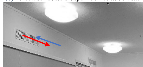
(d) Toevoer en afvoer direct naast elkaar levert kortsluitingsrisico tussen de toevoer en de afvoer.
