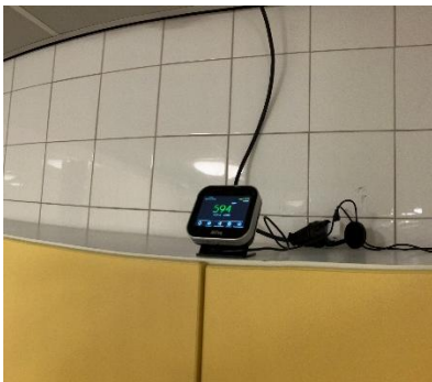
Figuur 28 AirTeq binnenklimaatmeter in kleedruimte zwembad
